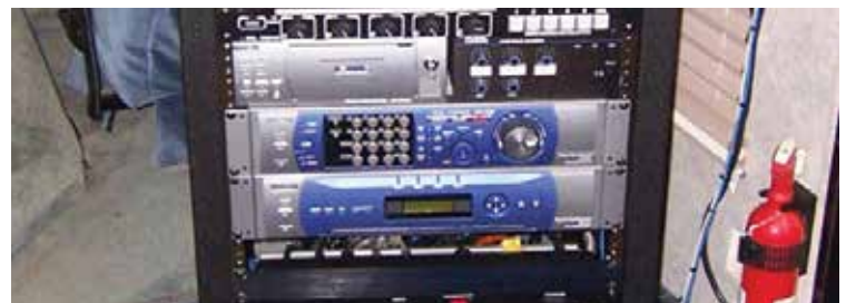
Atlas Rack Loaded with AV Equipment
